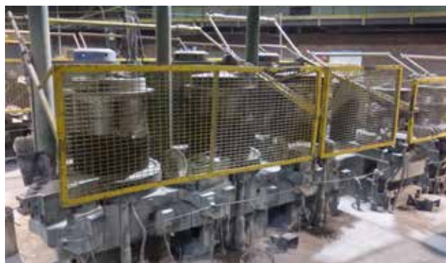
Rys. 5. Strefa dużych bębnow ciągnących przed modernizacją
