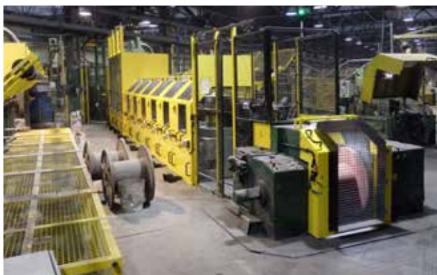
Rys. 6. Strefa nawijarki po modernizacji
