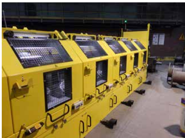
Rys. 2. Strefa małych bębnow ciągnących po modernizacji
